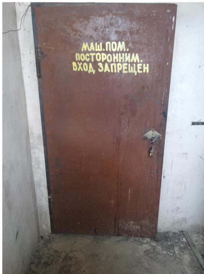
Рисунок 4 – Вход в машинное помещение
